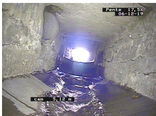
Fissures dans les murs
