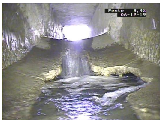
Effondrement du lit avec création d'une cavité
