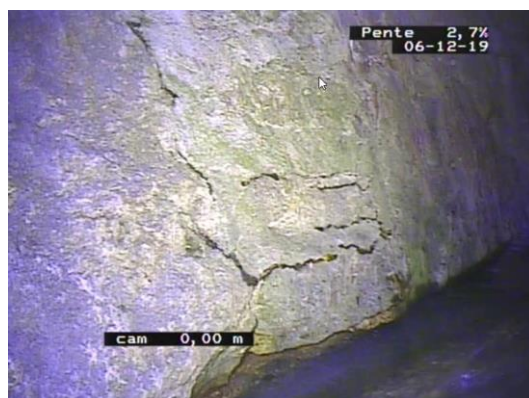
Fissures dans les murs
