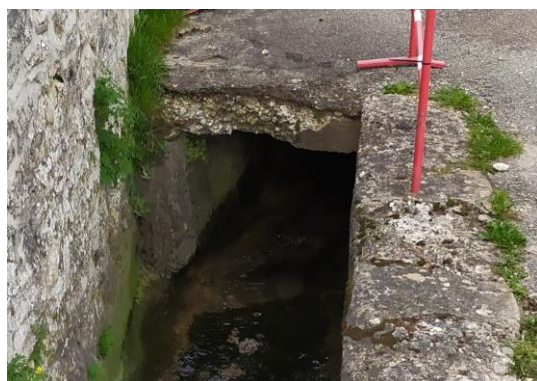
Dalle supérieure en mauvais état
